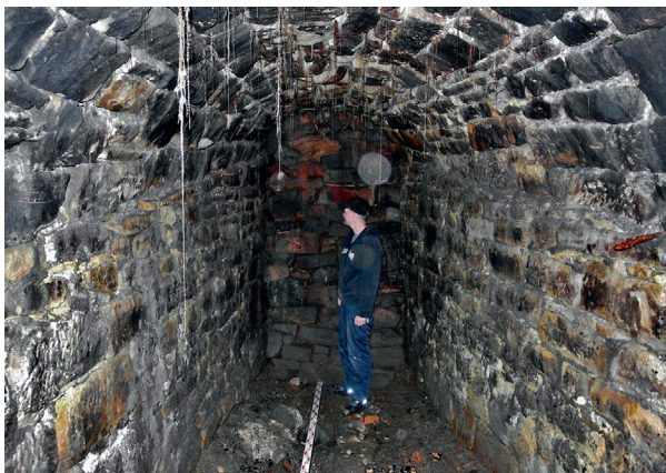
Abb. 81 Klein Süntel FStNr. 1, Gde. Stadt Bad Münder, Ldkr. Hameln-Pyrmont (Kat.Nr. 72). Intakter und nachträglich zugemauerter westlicher Schürkanal; Blick von Ost nach West. (Foto: P. Steppuhn)
