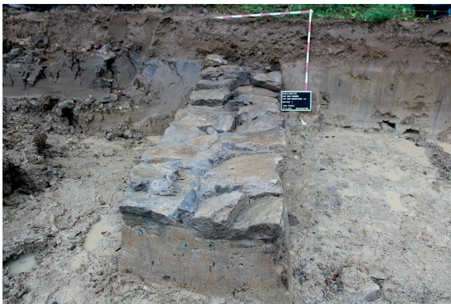
Abb. 112 Bad Münden FStNr. 147, Gde. Stadt Bad Münden A.D., Ldkr. Hameln-Pyrmont (Kat.Nr. 182). Ansicht des Fundamentes Bef. 1. Blick zur südlichen Grabungsgrenze. (Foto: A. Kis)
