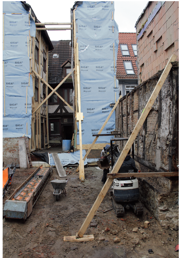
Abb. 138 Hannover FStNr. 182, Gde. Stadt Hannover, Region Hannover (Kat.Nr. 219). Blick aus dem entkernten Hinterhaus Richtung Hof und Vorderhaus. (Foto: M. Brückner)
