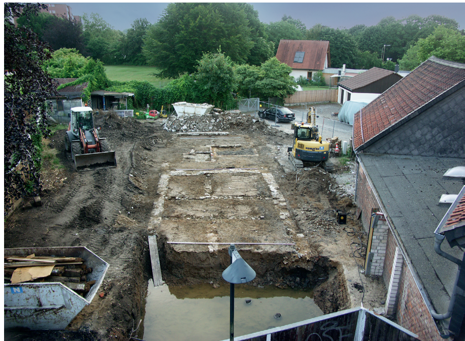
Abb. 293 Peine FStNr. 155, Gde. Stadt Peine, Ldkr. Peine (Kat.-Nr. 438). Blick aus erhöhter Position von N auf die freigelegten Grundmauern des abgerissenen Gebäudes Damm Nr. 24, das nach dem Ergebnis der Ausgrabungen erst im 18. Jh. auf Anfüllungen im moorigen Untergrund der Fuhseniederung erbaut worden ist. Im Vordergrund die Grube des ausgebrochenen modernen Kellers, unter dem gut 19 Pfahlgründungen zutage kamen. Diese sind vermutlich einer älteren Nutzungsphase zuzuweisen – aufgrund von Keramikfunden auf der Grubensohle vielleicht um 1600. (Foto: T. Budde)
