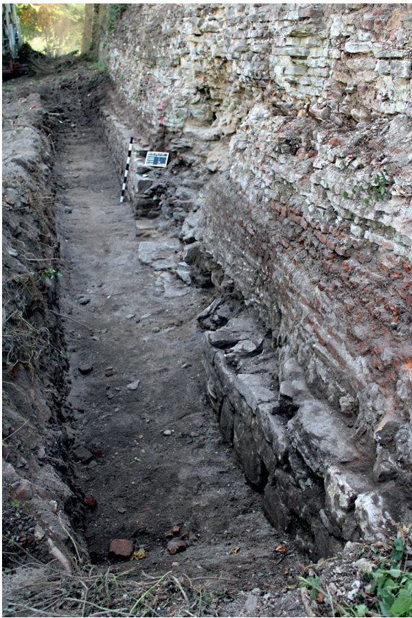
Abb. 124 Neustadt a. Rbge. FStNr. 23, Gde. Stadt Neustadt a. Rbge, Region Hannover (Kat.Nr. 204). Reste der Vorsatzschale der Südbastion von Schloss Landestrost, die im Rahmen der Mauersanierung aufgedeckt wurden. (Foto: B. Thiemann)
