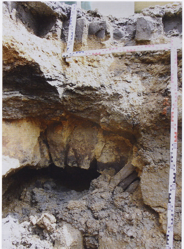
Abb. 19 Angeschnittenes Kellergewölbe im Straßenbereich des Marktes.
