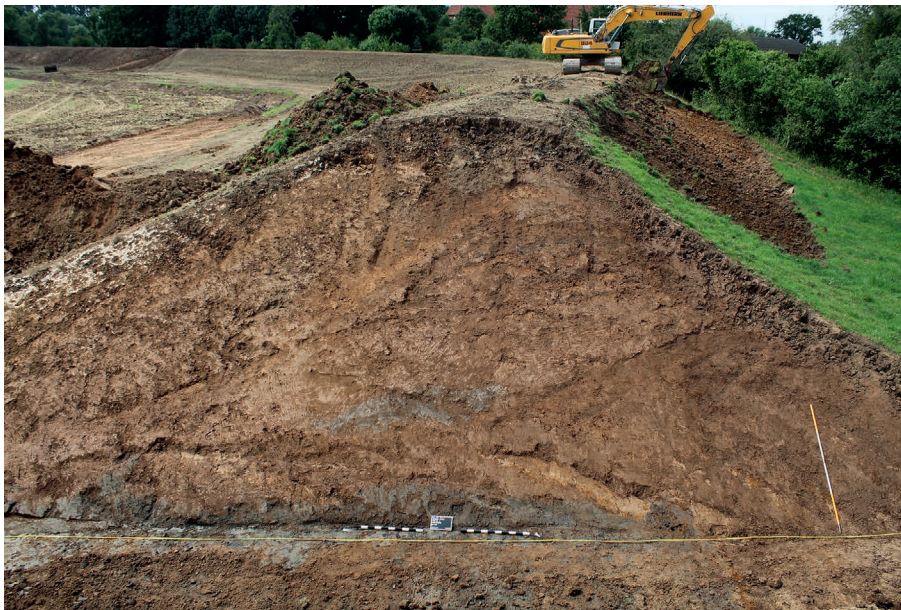
Abb. 334 Oiste FStNr. 2, Gde. Blender, Ldkr. Verden (Kat.-Nr. 454). Schnitt durch den Altdeich. (Foto: O. Knof)
