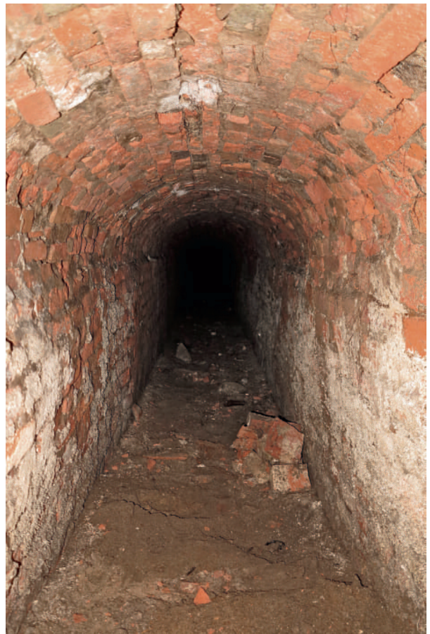
Abb. 272 Stade FStNr. 270, Gde. Hansestadt Stade, Ldkr. Stade (Kat.Nr. 386). Blick in den Gang. (Foto: Stadtarch. Stade)
