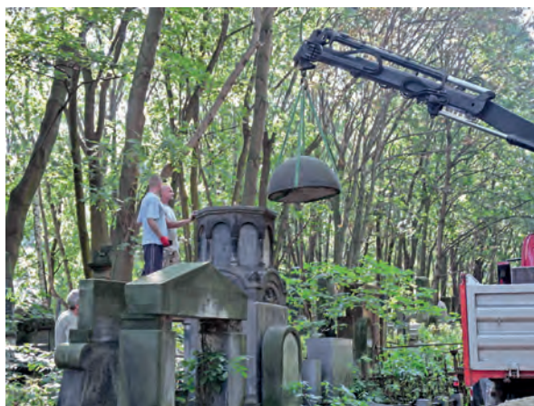
II. 24 Nagrobek Magnusa Kryńskiego (kwatery 64, rz. 2), stan w trakcie konserwacji, fot. Magdalena Olszowska, 2016
