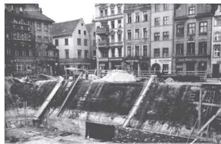
il.19 Budowa schronu przeciwlotniczego pod pl. Nowy Targ, fot. z września 1941 r., za: internet.
