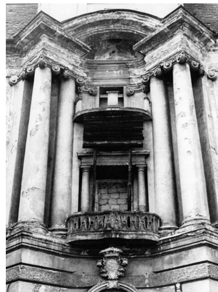
il.24 Pieszyce, pałac, fasada, ryzalit środkowy z balkonem nad wejściem głównym, stan przed remontem. Fot. R. Hołownia
