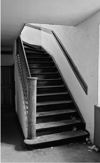
il. 18 Klatka schodowa między partem i II kondygnacją, stan w 2002 r. Fot. Rafał Eysymontt
