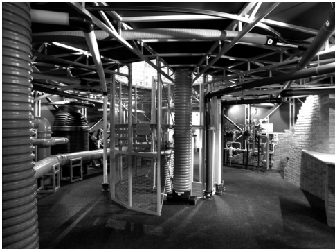
il. 17 Wystawa „Wrocław Moje Miasto”, Infrastruktura pod Rynkiem, fot. Ja- nusz Bohajczuk
