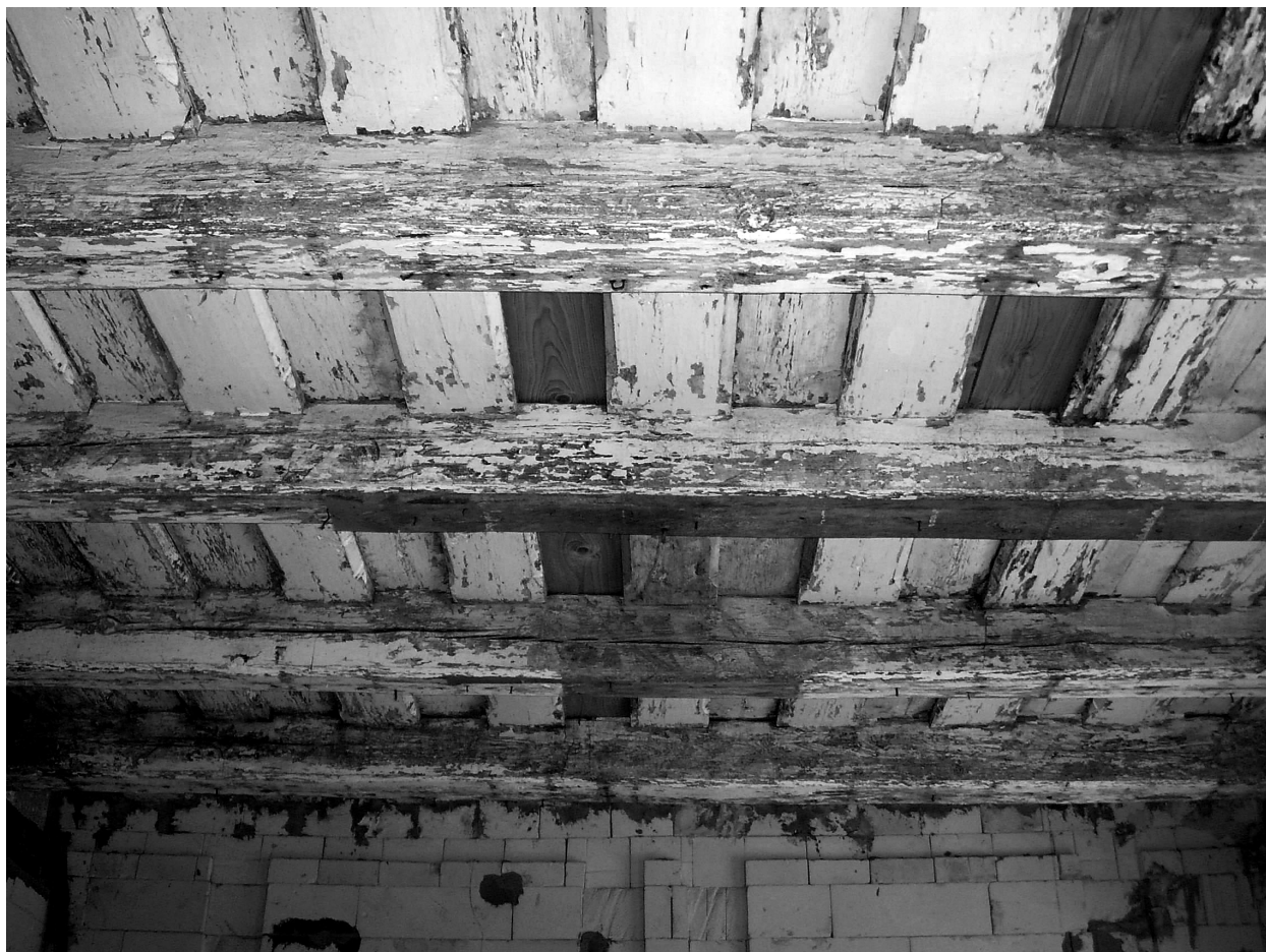
Il. 5 Stan stropu przed konserwacją. Fot. M. Kaluch-Tabisz
