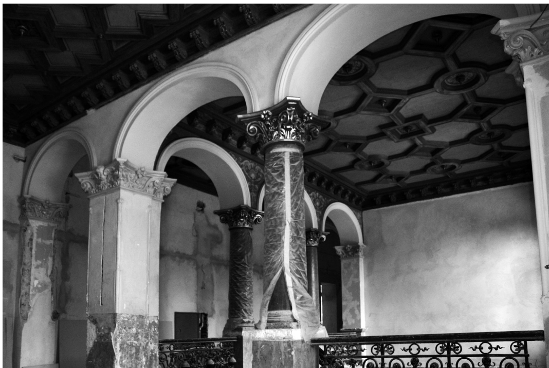
il. 9 Pałac w Kwietnie (Blumerode), hall w trakcie prac renowacyjnych, 2012. Fot. E. Grochowska
