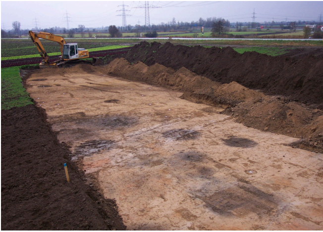
9 Das Pipelineprojekt über 73 km von Ludwigshafen nach Wörth war der Anlass zur Verschriftlichung der Ausgrabungs- und Dokumentationsrichtlinien (Foto: H. Stickl).
