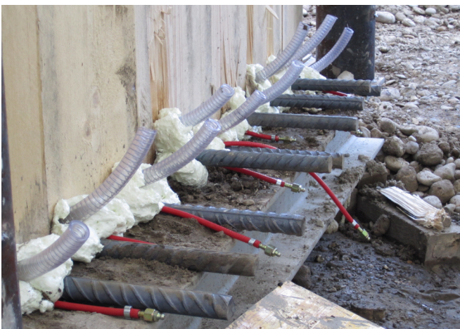
9 Armierungseisen und durch die Bohrungen gezogene Schläuche vor dem Einpressen des Kunstharzes (Foto: Norbert Spichtig, ABBS).
