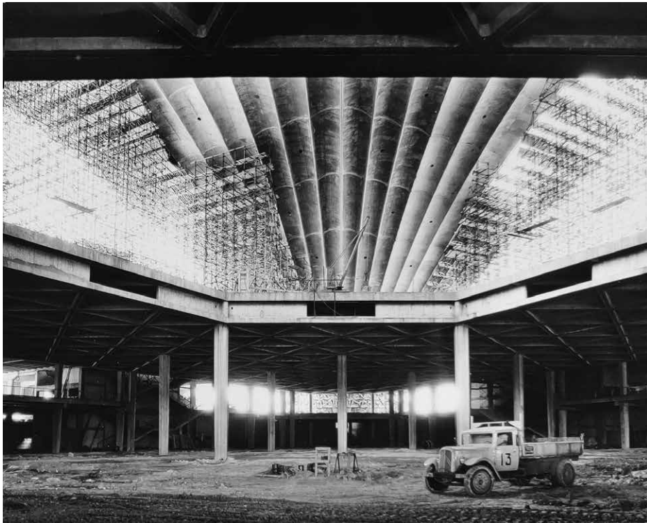
22 CNIT in cantiere (progetto di Bernard Zehrfuss, Nicolas Esquillan, Jean Prouvé), 18.7.1958, Parigi, fotografia di Jean Biaugeaud. Parigi, CdA – Fonds Bernard Zehrfuss (foto CdA)
