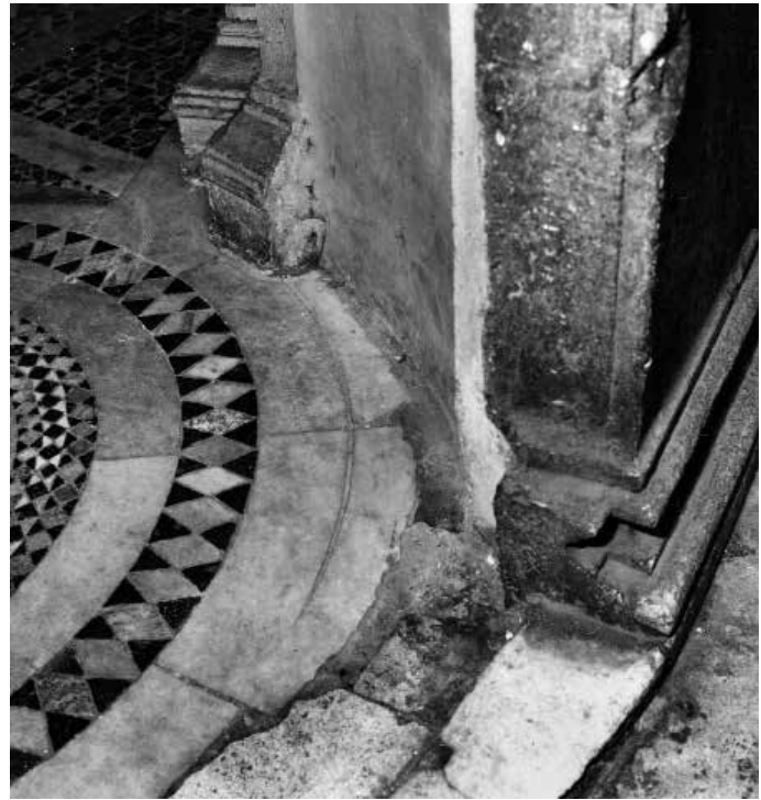
4 Rom, San Pietro in Montorio, Tempietto, Seiteneingang Süd: Fußbodenrandplatte mit Ritzkreis und unregelmäßigem Abschluss, der unter das geplante Sockelprofil reichte. Abbruch des attischen Wandsockelprofils im Türdurchgang und innen am Beginn der Konche (Foto Bibliotheca Hertziana)
