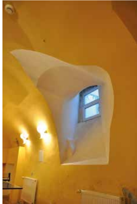
Il. 4. Przysiek, pałac. Nierówno rozglifiony otwór okienny w zachodniej ścianie pomieszczenia piwnicznego pod południowo-zachodnią częścią pierwotnego skrzydła [autor: Grzegorz Grąbczewski, 2018]
