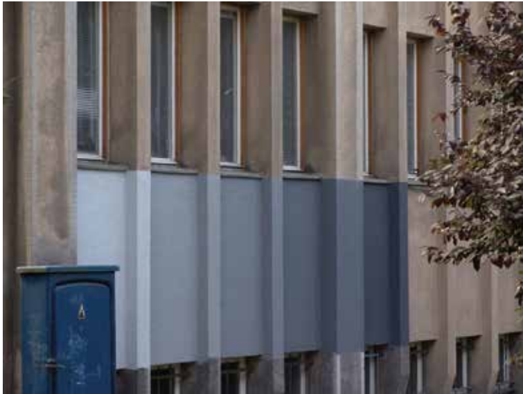
Il. 12. Gmach Starostwa Krajowego Pomorskiego w Toruniu, ob. Collegium Minus UMK. Fragment elewacji północnej. Próby kolorystyczne nowej warstwy malarskiej wykonane podczas prac konserwatorskich w 2005 r. (fot. Sławomir Wojdyło, 29.08.2005)
