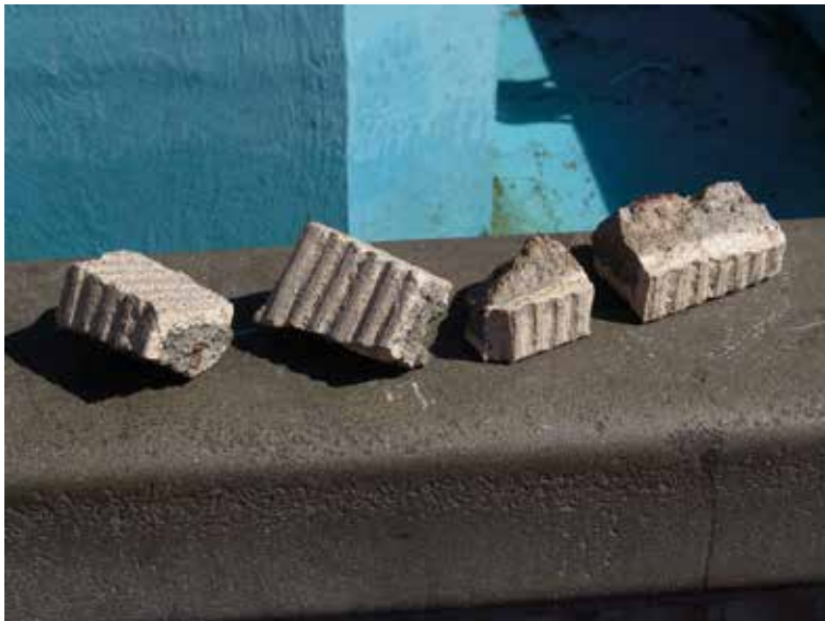
Il. 13. Fragmenty oryginalnych wypraw tynkarskich – odspojone a następnie zrekonstruowane w trakcie prac konserwatorskich w 2005 r. (fot. Sławomir Wojdyło, 29.08.2005)
