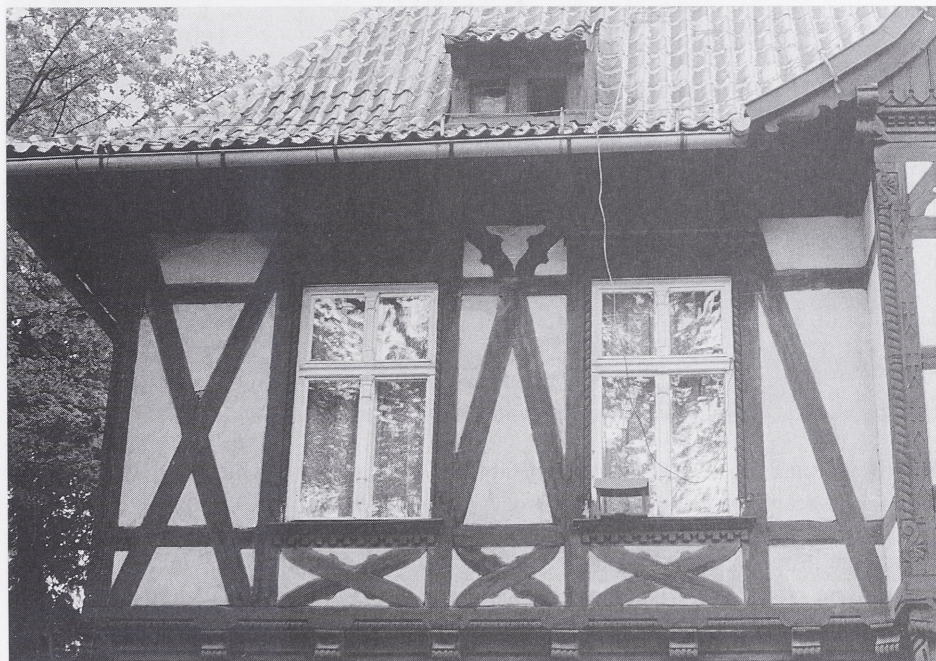
Ryc. 7. Toruń, ul. Bydgoska 34/36. Fragment elewacji południowej. Układy mieczy i zastrzałów. Fot. P. Grajek
