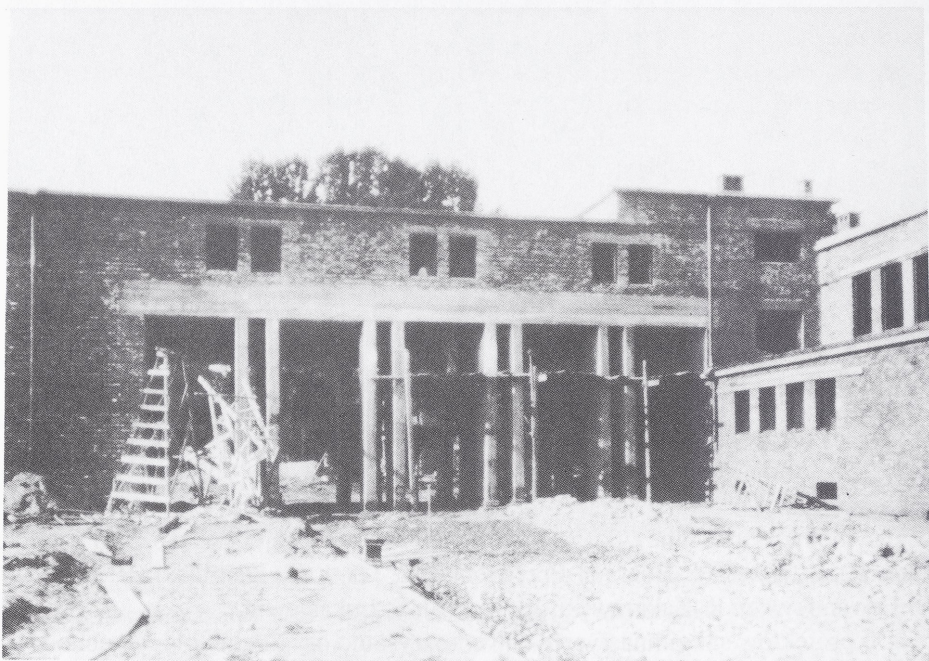
Ryc. 9. Widok propylei od strony zachodniej, stan z maja 1929 (wg oryg. Archiwum AWF, fot. W. Zawistowska)
