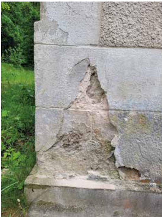
Ryc. 3. Wojcieszów, pałac, zdjęcie narożnika przybudówki wschodniej, widoczne warstwy tynku. oprac. A. Walkowska
