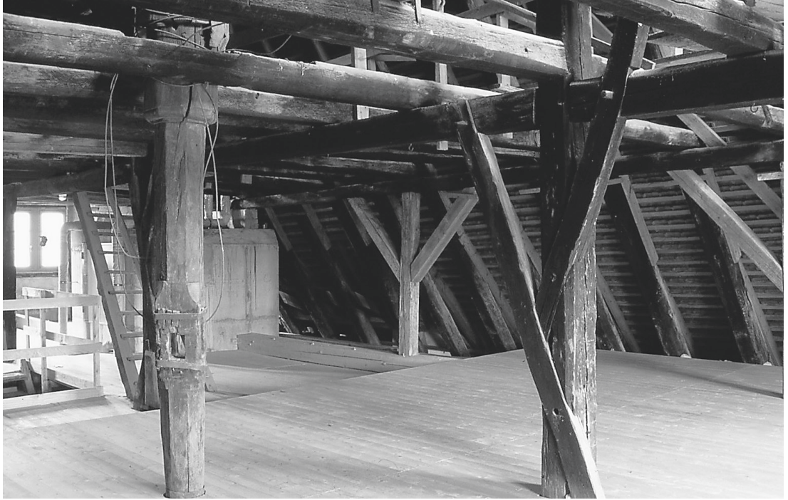
Abb. 7: Riedlingen, Wochenmarkt 3. Mittelalterliche Dachwerkkonstruktion im 2. Dachgeschoss. Die mittelalterliche Konstruktion ist für die beachtlichen Spannweiten relativ schwach dimensioniert und musste später mehrfach unterstützt werden.
