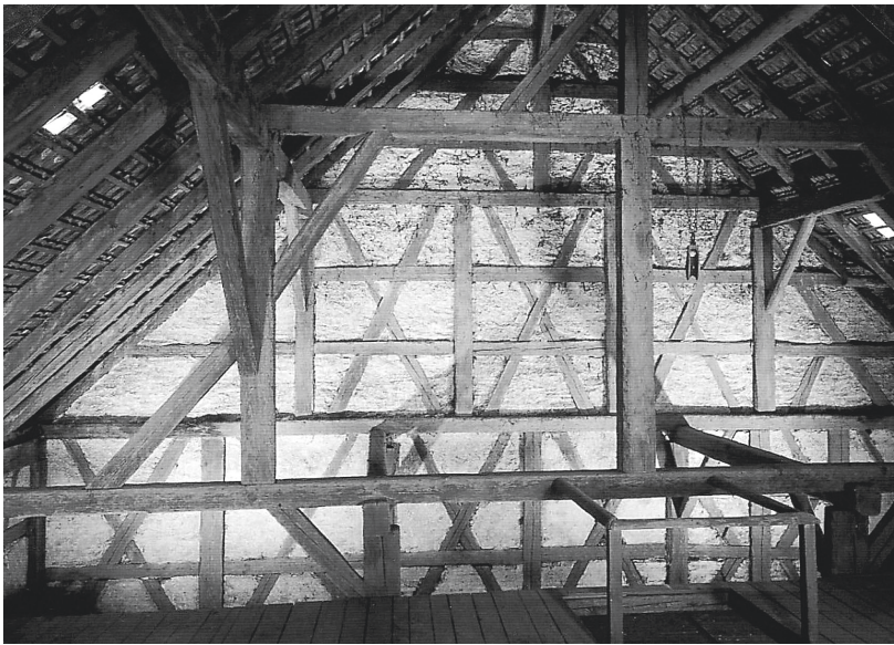
Abb. 22: Stein am Rhein, Bürgerasyl. Ökonomiebau, Dachwerk, Detail: Sparren, welche im Traufrähm fußen. 1. Hälfte 17. Jahrhundert.
