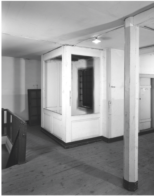
Abb. 28 (links): Stein am Rhein, Asyl. Zweites Obergeschoss, Zustand 1996. Treppenhaus und Lichtschacht im Asyl West von 1864 (a).
