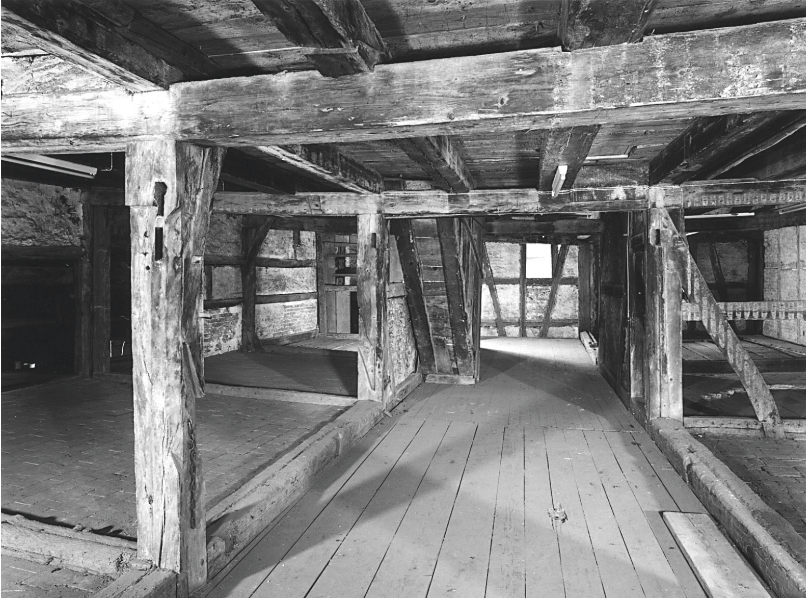
Abb. 7: Stein am Rhein, Spittel. Obergeschoss von Norden. Mittelquergang mit begleitenden Raumfluchten, 1478/79 (d).
