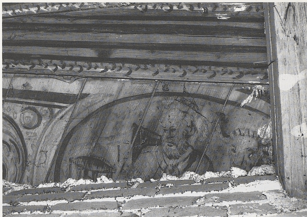
Abb. 6: Schloß Haltenbergstetten. Südwestecke im zweiten Obergeschoß, in einer Putzkammer erhaltener Deckenausschnitt aus dem 16. Jahrhundert, der Reste einer figürlichen und ornamentalen Malerei zeigt. Es ist davon auszugehen, daß die ursprüngliche Decke einen größeren Raum umfaßte.
