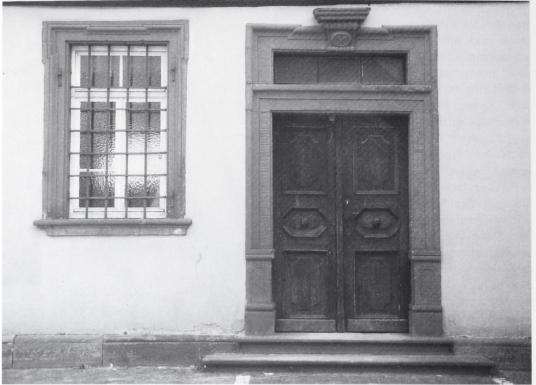
Abb. 18: Schriesheim, Rathaus. Sandsteinportal mit danebenliegendem Fenster auf der Westseite. Bei der Umbaumaßnahme 1791 wurde die ursprüngliche Fachwerkwand im Erdgeschoß durch eine Mauerwand ersetzt und der Hauptzugang von der Vorhalle hierher verlegt. Die Gewände sind der Barockzeit entsprechend stark profiliert und geohrt.
