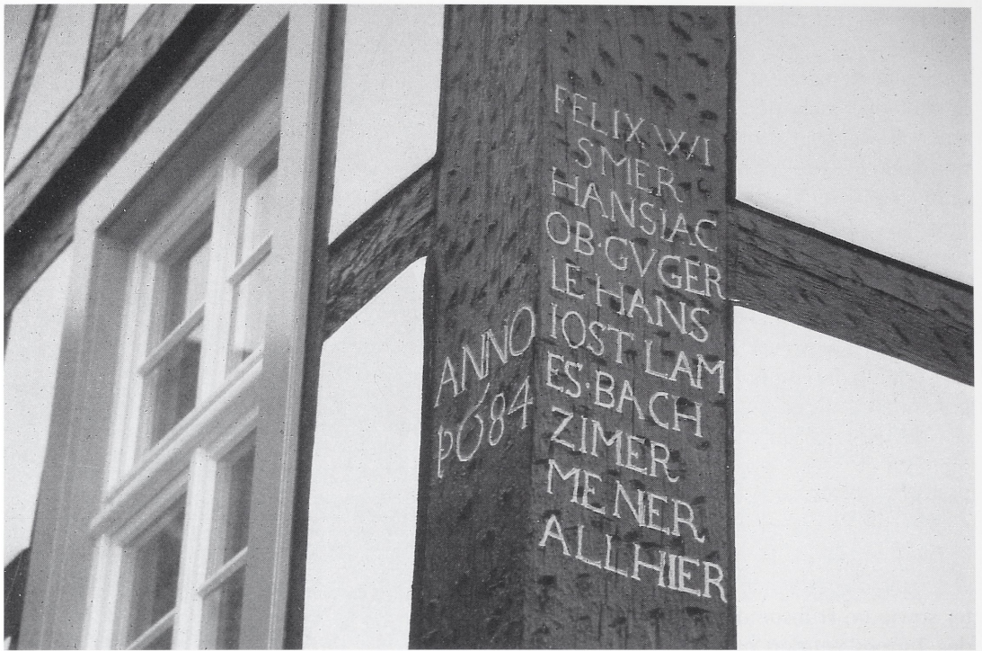
Abb. 8: Schriesheim, Rathaus. Detailaufnahme des hölzernen Eckständers im Obergeschoß; hier haben sich die an der Errichtung des Rathauses beteiligten Zimmerleute verewigt: Felix Wismer, Hans Jacob Gugerle, Hans Jost Lamesbach.
