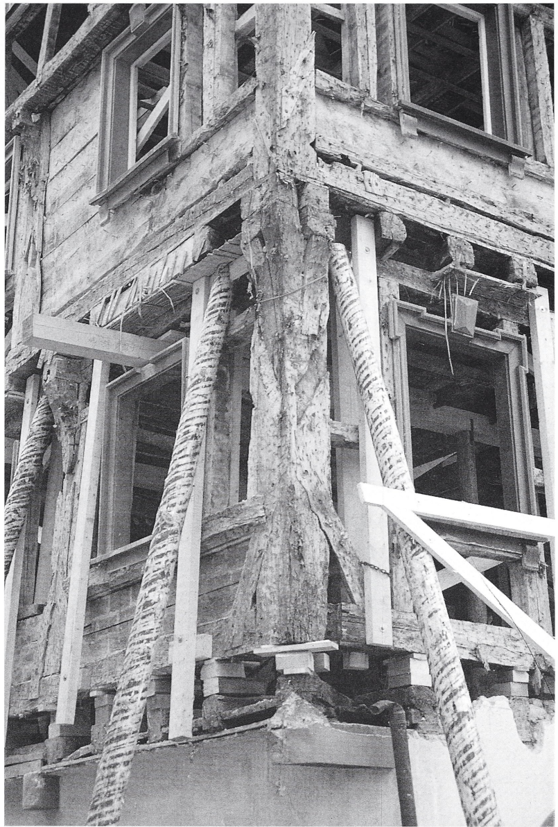
Abb. 5: Meßkirch, Hauptstraße 27. Blick auf den nordöstlichen Eckständer des ersten Obergeschosses während der jüngsten Sanierung.
