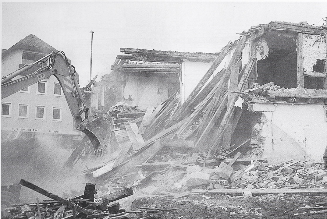
Abb. 7: Leonberg, ehemaliges Schießhaus. Abbruch der Bohlen-Balken-Decke des Saals von 1581. Die Deckenbalken brechen über dem ursprünglich freilegenden Unterzug ab.
