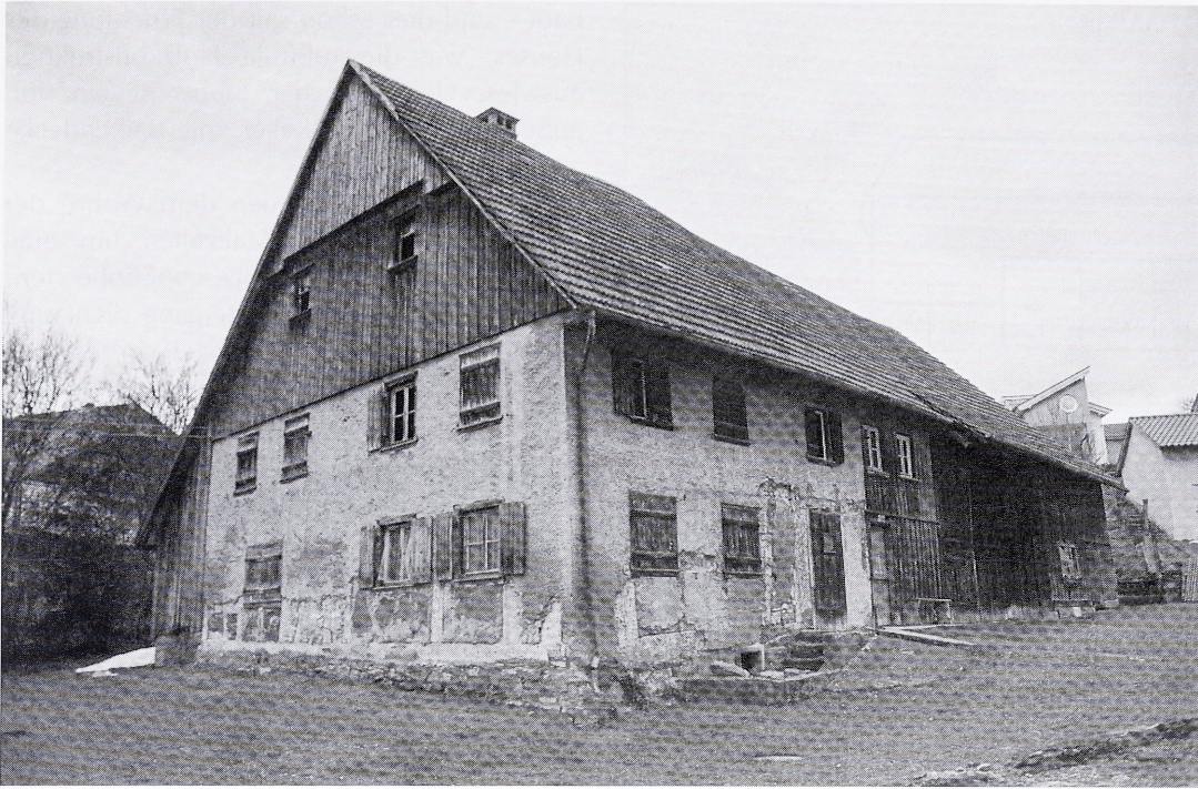
Abb. 21: Dunningen, Rottweiler Straße 3. Aufnahme des derzeitigen Zustands mit begradigtem Vordergiebel, zurückgestutztem Dachvorsprung, entferntem Laubengang und verputzten oder verschalteten Außenwandflächen.
