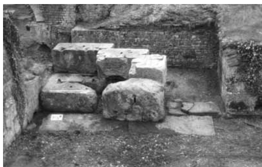
Abb. 3 Trier, Barbarathermen, Quaderkonstruktion zwischen Hof 25 und Gang 24, von Westen (Foto: M. Dodt, RE 2003/52, 32).
