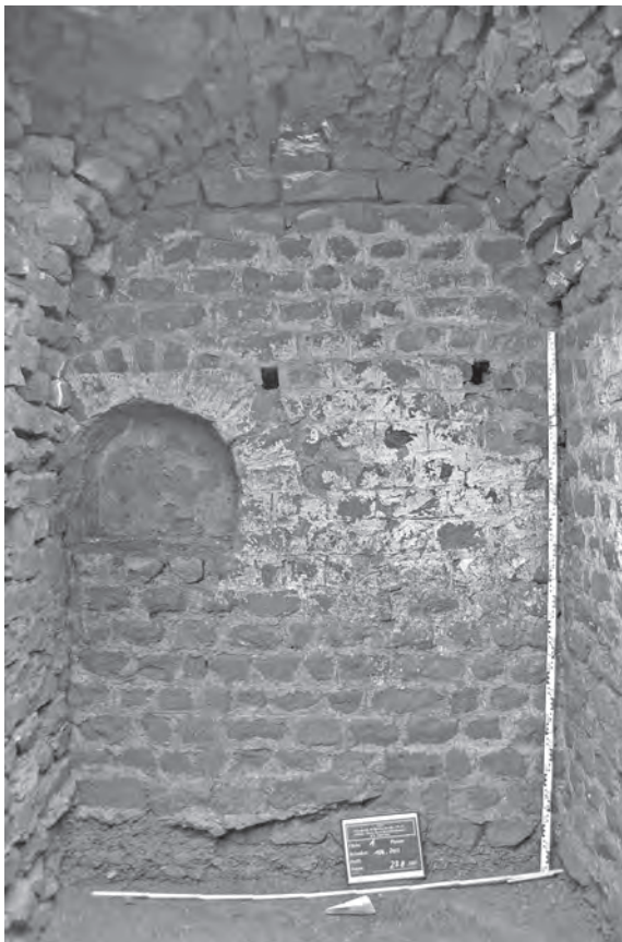
49 Trier, Friedrich-Wilhelm-Straße 29/31. Rotsandsteinkeller, Ostwand mit Nische (ursprünglich mittig in der Wand sitzend) und Balkenlöchern (Foto: K. Bissinger, RE 2007,50/18).
