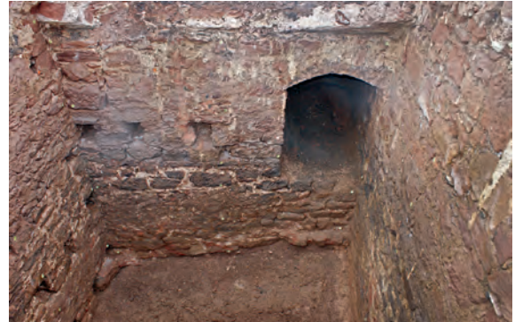
21 Burg Ottenstein. Wasserrückhaltekommer an der Burgaußenseite mit Eintrittsöffnung des Kanalzulaufs in der Südwand (oben links im Mauerwerk sichtbar eine zugesetzte Bauöffnung).
