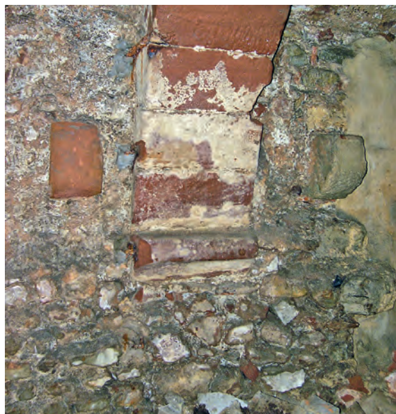
26 Trier, Rindertanzstraße 12. Mittelalterlicher Keller, Ostwand. Profilierte Kämpferplatte des Gurtbogens mit Deckenkonsolen einer älteren Bauphase (Foto: B. Kremer, Digi-EV 2009,229/8).
