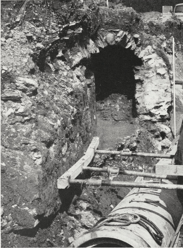
Abb. 2 Leitungsquerschnitt bei K in Flußrichtung gesehen (Lage vgl. Abb. 1). Die Kanalbiegung ist durch kurze gerade Mauerstrecken hergestellt, an den horizontal angeordneten Kanthölzern der Baugrubenaussteifung ersichtlich
